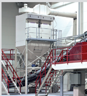
HKD III - Dedusting system HKD III - Entstaubungsanlage
